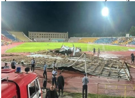
Рис. 2. Обрушение крыши здания Центрального стадиона, г. Шымкент
